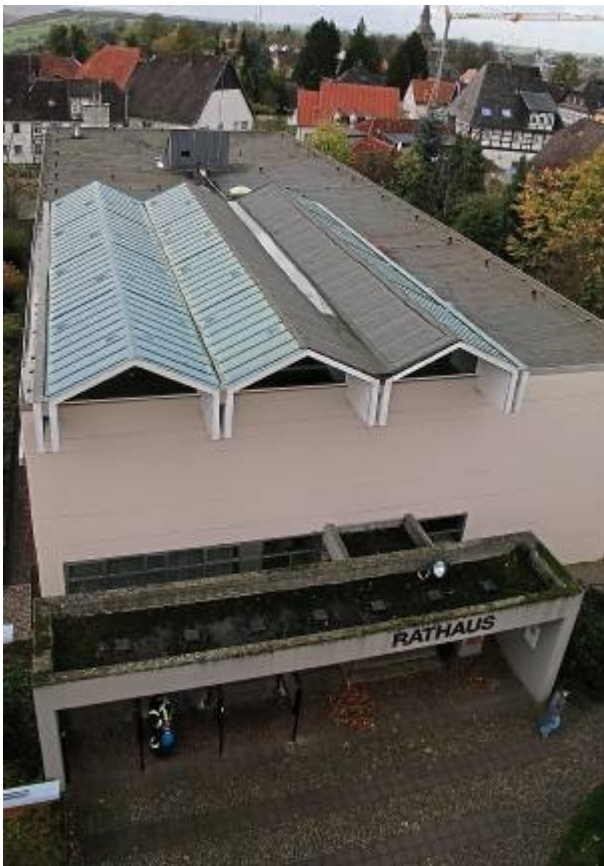
Auch das Dach ist sanierungsbedürftig. Foto: Schönhense
